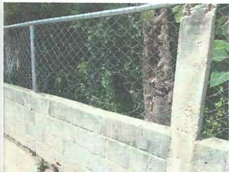
Foto1: Malla perimetral dañada y rota.
