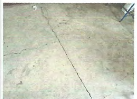
Foto 5: Piso de torta dañado y agrietado.
